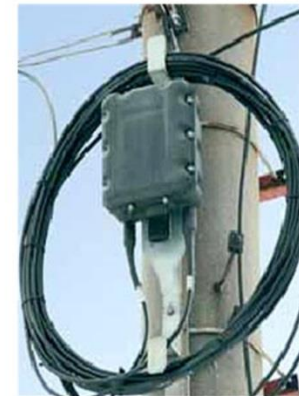
Муфта в пластиковом корпусе с креплением технологического запаса кабеля на опоре
